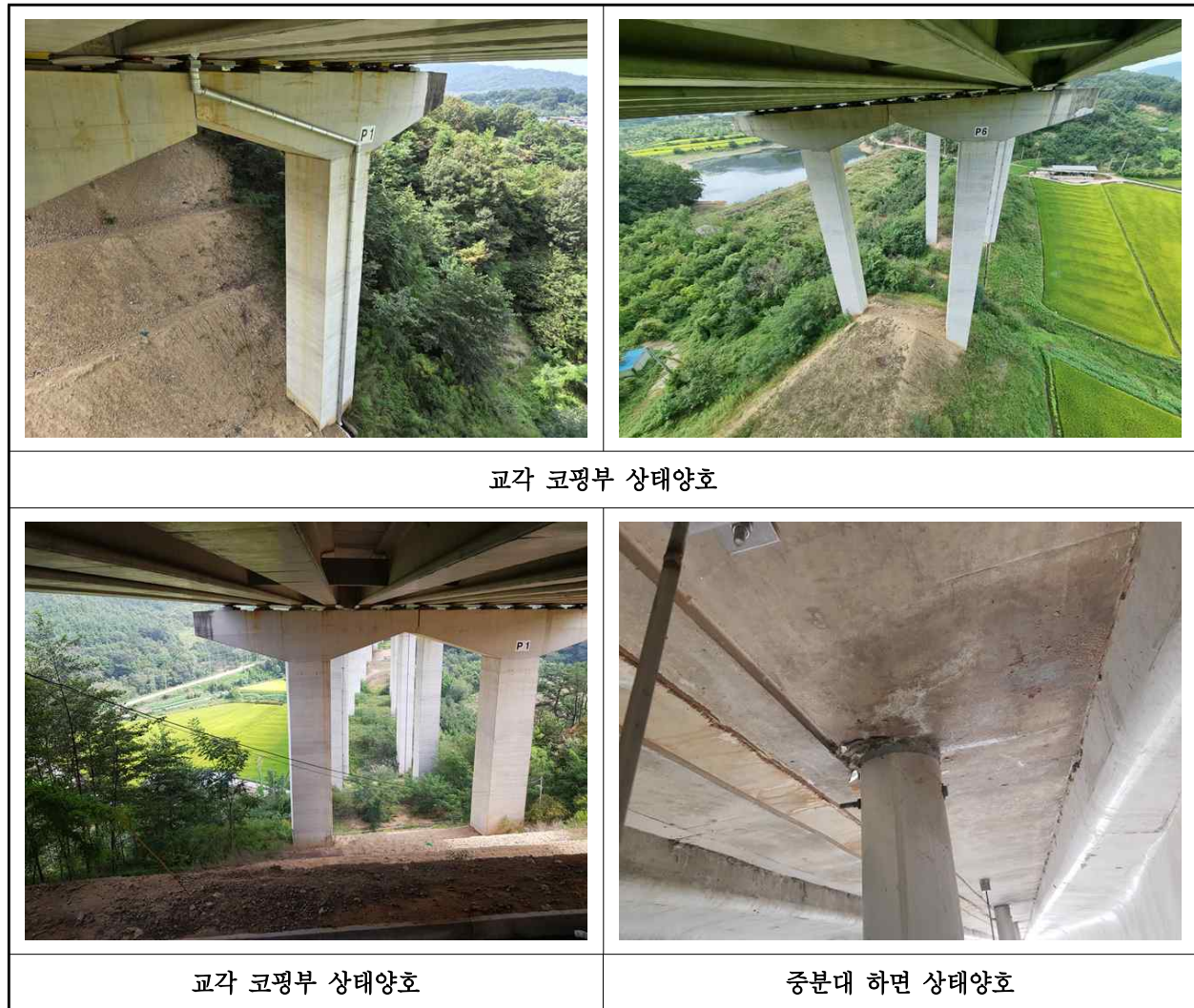
【사진 2.3.28】 교량의 공중이용시설 10대 위험요소 손상현황
